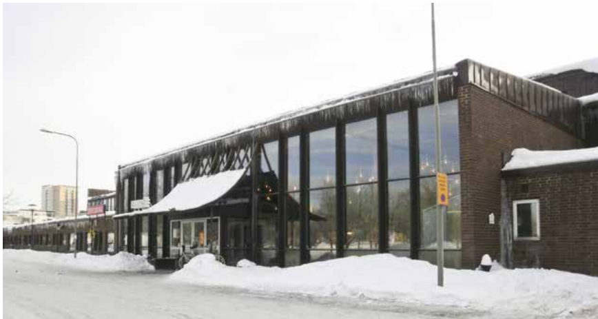
Kraftig nedisning utmed fasaden. Om detta problem återkommer finns stor risk för allvarliga skador i byggnadskonstruktionen.
