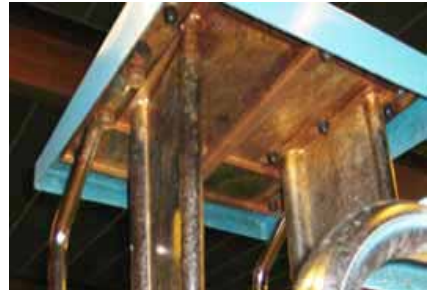
Korrosion upplevs visuellt negativt av badgäster.
