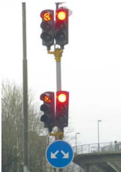
Bild 2. Vid separatreglerad vänstersväg hamnar sekundärsignalen ofta på mittrefug i frånfarten. Det viktiga är då att montera sekundärsignalen intill sekundärsignalen med cirkulär ljusöppning (6 §). Antingen på normal höjd, på hög höjd eller som på fotot på båda höjderna.
